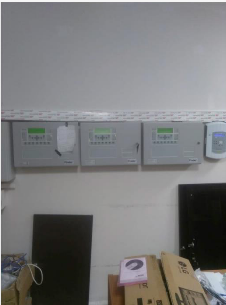
Yangın Söndürme Otomasyon Sistemi Kontrol Paneli
