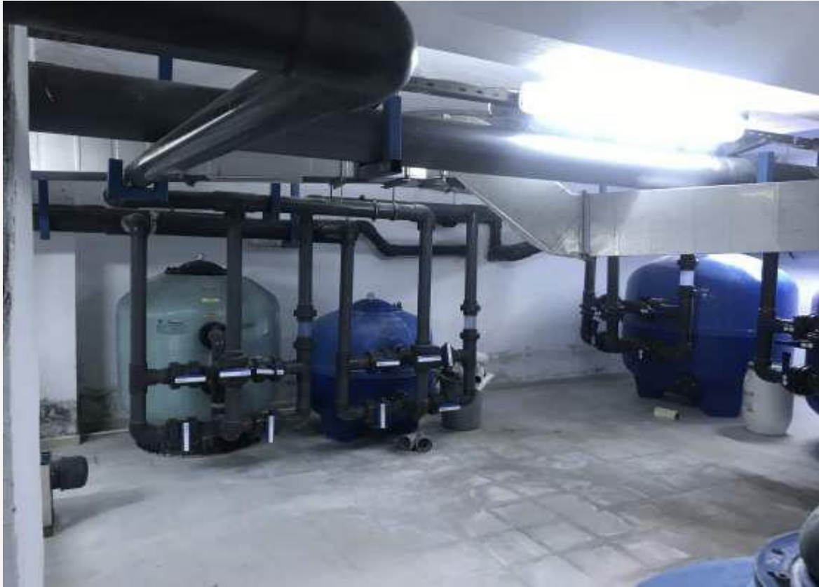
Spor Tesisleri Yüzme Havuzunun Su Arıtma Sistemi
