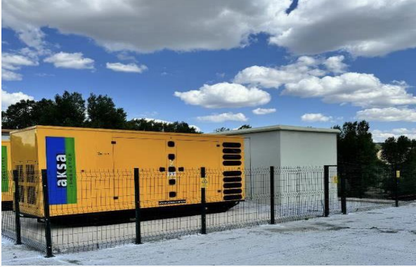
Sulusaray Jeneratör Projesi Uygulaması
