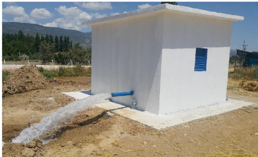
İçme suyu kuyusu pompa istasyonu
