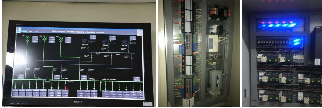
Enerji izleme ve kontrol sistemi, PLC panosu ve güç panosu
