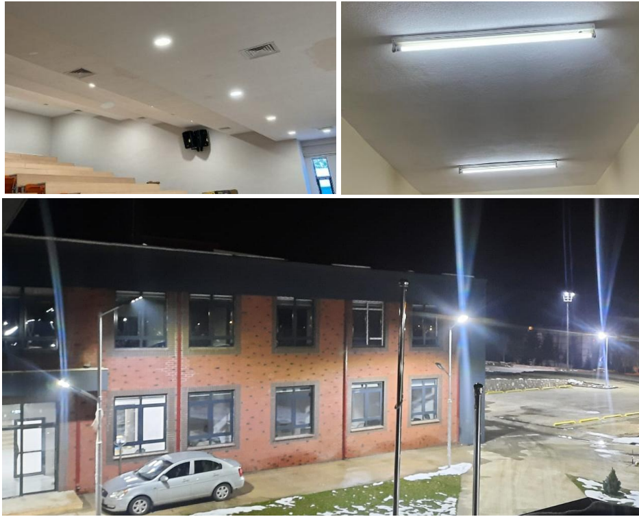
Enerji verimli LED armatürler
