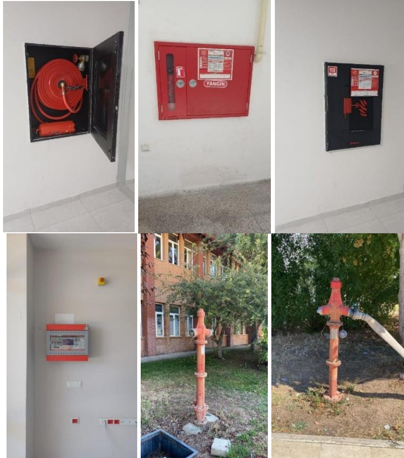
Binaların iç ve dış alanlarındaki yangın muslukları (hidrantları)
