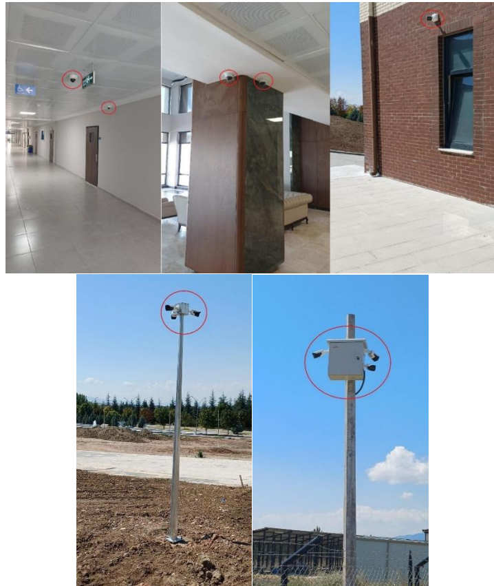
Binaların iç ve dış alanlarındaki güvenlik kamerası (CCTV) sistemleri
