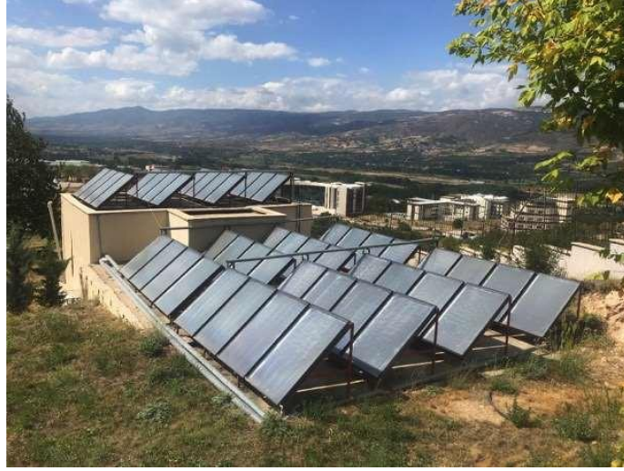
Güneş kolektörleri (güneş termal panelleri)
