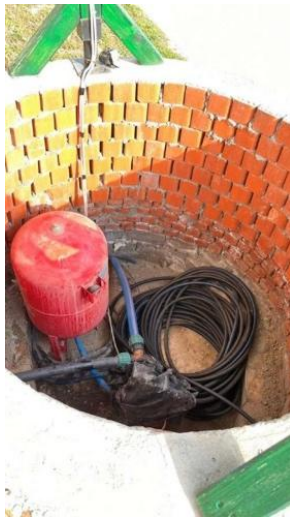
Pazar Yerleşkesi bahçesinde sulama amacıyla kullanılan yeraltı su kuyusu
